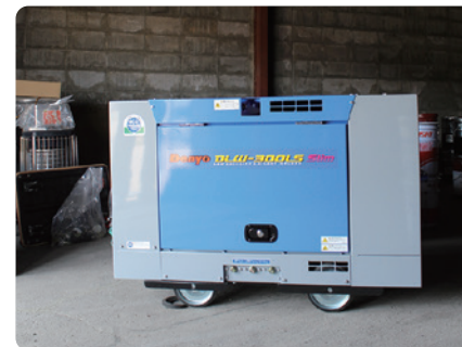
燃料供給業者の非常用発電機 停電時は燃料供給用ポンプの電源となる。
