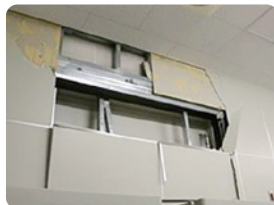
原料棟(1)クリオフリーザ置場 外壁が破損していた。
