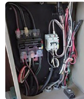
非常用発電機の電源切り替え盤 燃料供給業者も非常時の対応を訓練している。
