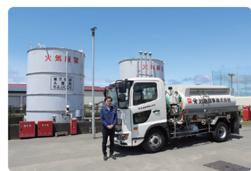
燃料供給業者の給油設備、屋外タンク、ローリー車
